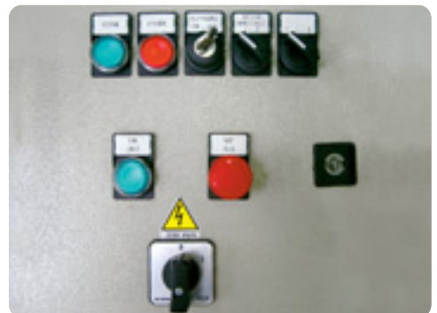
Unidad de control
